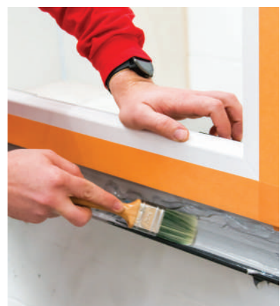
17 Haga que la parte externa sea estanca al aire y a las lluvias fuertes con, por ejemplo, Soudatight Hybrid
