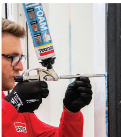
15 Retire las pinzas y cierre la junta de conexión entre el marco y la ventana
